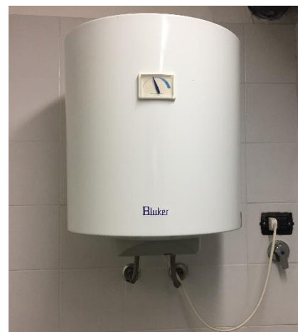
Figura 4.11 - Particolare di un boiler elettrico usato per la produzione di acqua calda sanitaria
